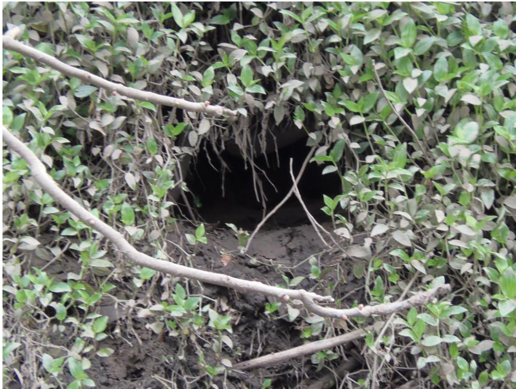
Figura 18 - Aspeto de uma das frequentes cavidades associadas à margem esquerda a jusante.
